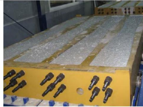
b) fôrmas preenchidas com concreto. Os fios de protensão são relaxados das ancoragens somente após o concreto apresentar a resistência requerida;
